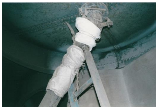
Fot. 4. Prowizoryczne i tymczasowe (funkcjonujące kilka lat) uszczelnienie rury spustowej. Pęknięta rura spustowa została „zabezpieczona” workiem jutowym (fot. K. Grad)
