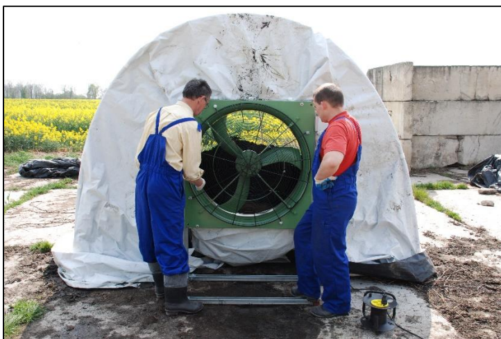
Fot. 42. Montaż tunelu aerodynamicznego. ZD IZ PIB Żerniki Sp. z o.o. (fot. J. Walczak)
